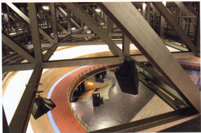
Eine der APOGEE AE-7 in der Dachkonstruktion
