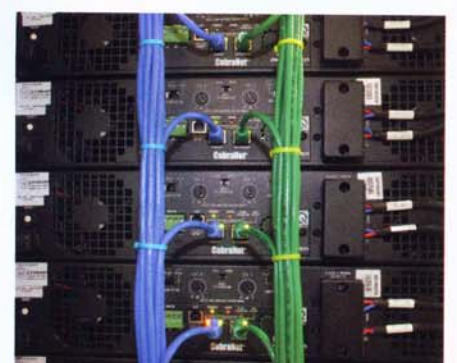
Die Weiterleitung der Audio- und Steuerdaten ist bis zu den Verstärkern redundant ausgeführt
